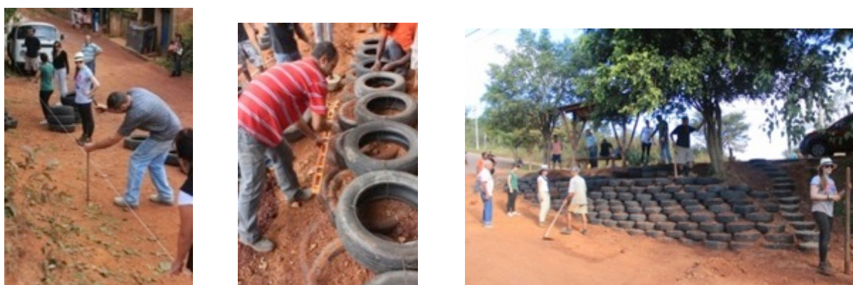
Figura 8: Capela Velha- mutirão para a construção do muro de pneus Fonte: www.arq.ufmg.br/praxis/blog
